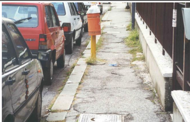
I marciapiedi in genere si presentano gravemente degradati
