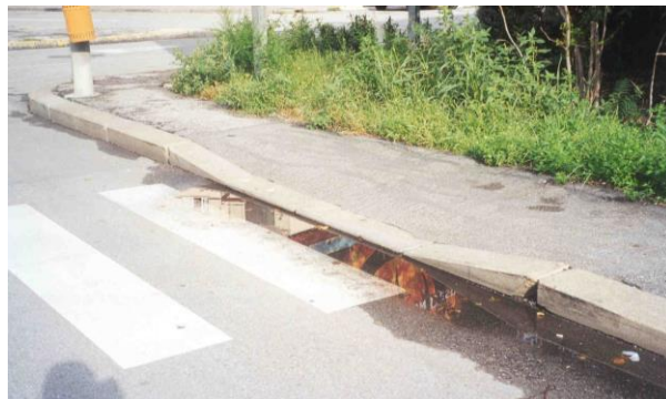
Quando piove si forma una pozzanghera all'inizio dell'attraversamento pedonale
